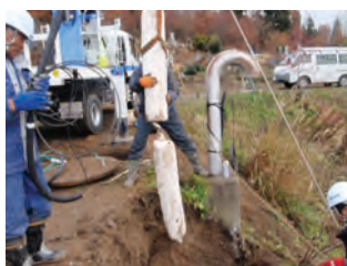
▲鋼管接続部 電気防食対策
