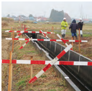
▲不等沈下の状況
