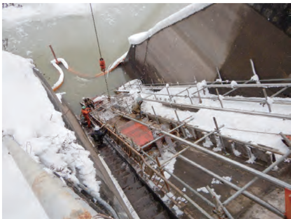
▲関柴ダム 取水ゲート 取水ゲート等の補修のためダムの水位を下げて作業中
