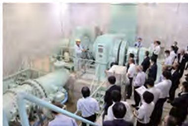
新宮川ダム発電所
