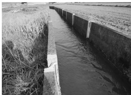
県営用水路(不同沈下)
