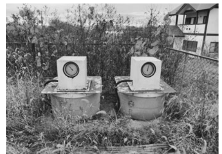
頭首工(水位計)
