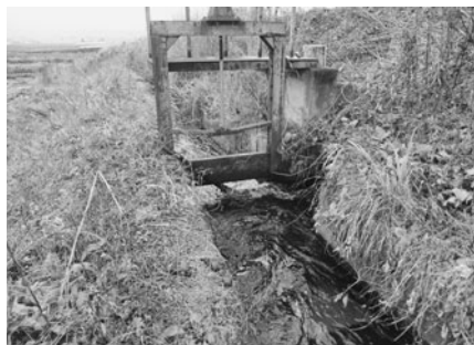
県営用水路(ゲート劣化)
