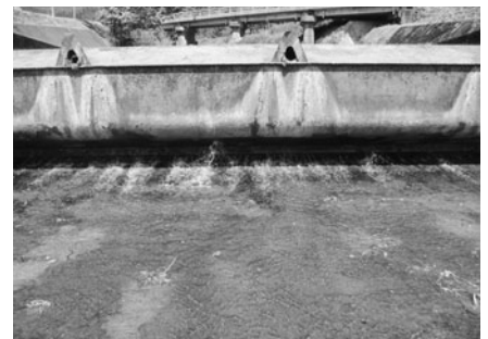
頭首工(河川ゲート)
