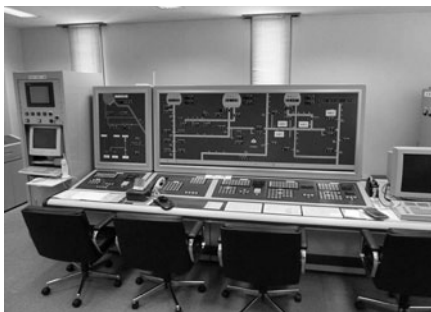
中央管理所(操作卓・表示パネル)
