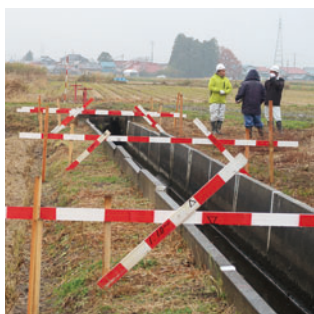
◀不等沈下の状況
