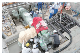
▲大平沼小水力発電所 発電機 (上から施工前、既設撤去、組立)
