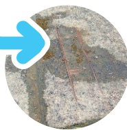
▶エプロン 摩耗による 鉄筋露出
