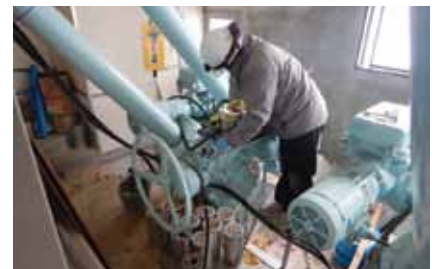
▲ゲート巻上機点検(電機部品・通信線)
