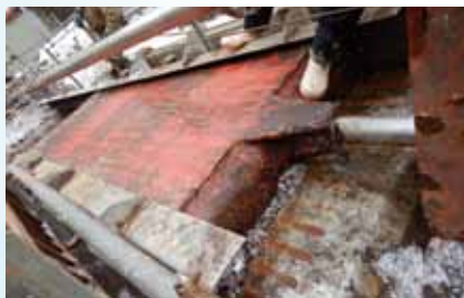
▲ゲート劣化状況
