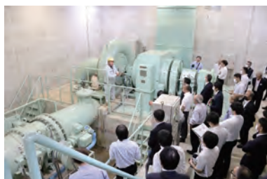
新宮川ダム発電所
